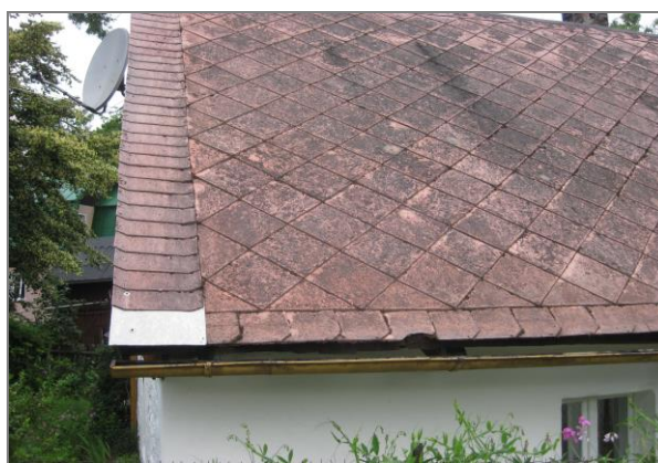
Fot. 2 Płyty azbestowo-cementowe płaskie
